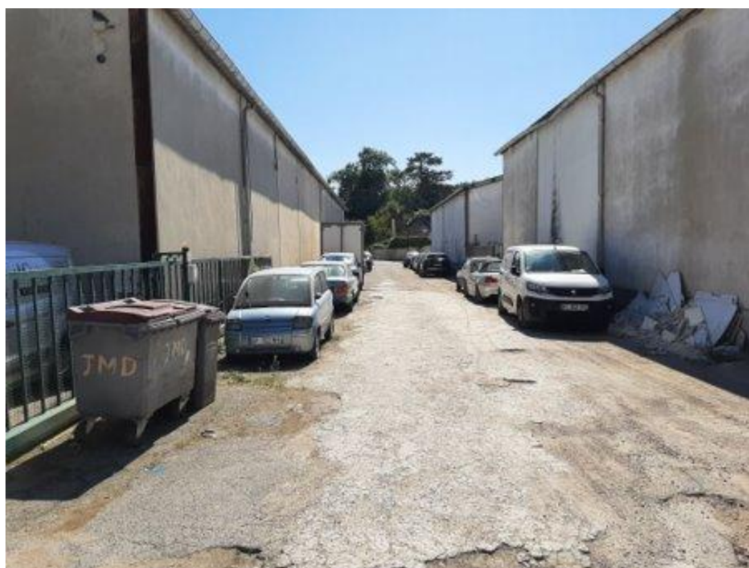
Voirie intérieure délabrée
