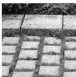
Dalles ou pavés non joints
