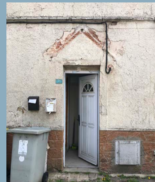
Les modénatures en mauvais état ou supprimés accélèrent la dégradation de la façade.
