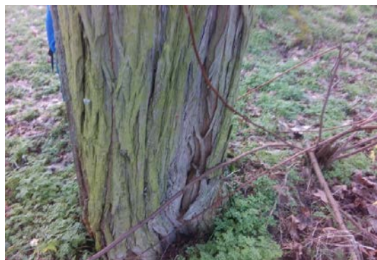
< Photo d'un défaut relevé ou détail sur sujet
