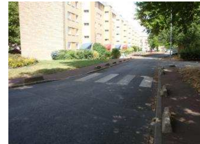
Traversée piétonne ne répondant pas aux normes PMR (Absence de bande podotactile)
