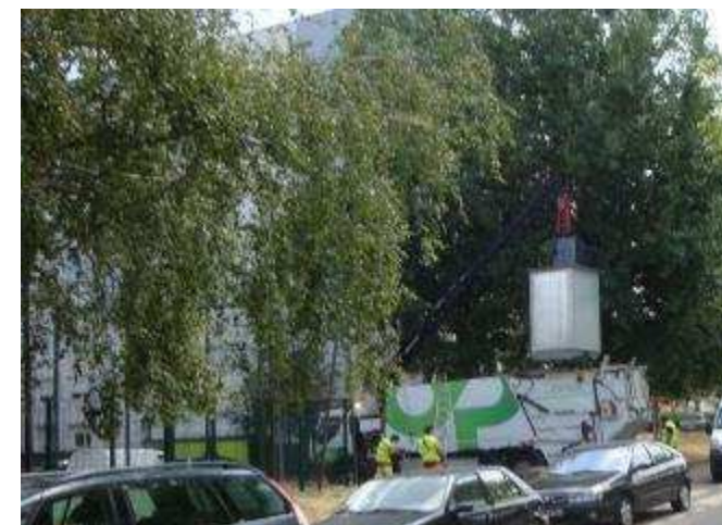
Collectes des déchets enterrés, rue Albert Doyen
