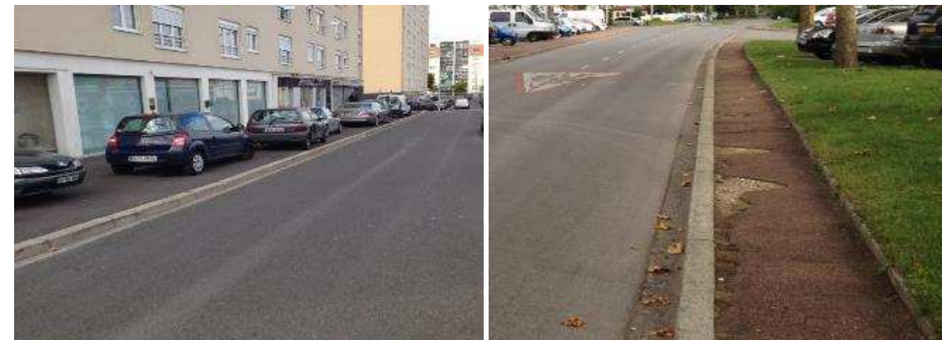
Stationnement sur trottoir et trottoirs vétustes - rue Henri Doucet
