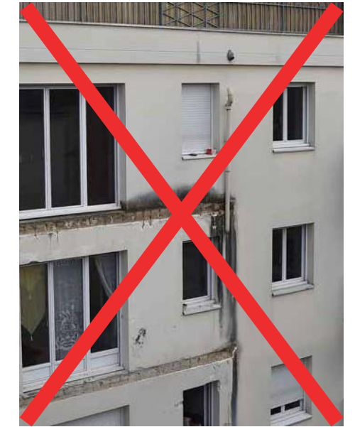
Eviter les marques d'usures d'un bâtiment
