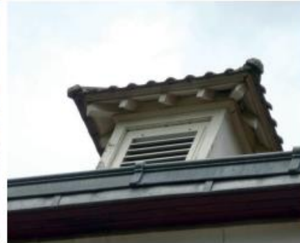
Corniches et cavités sur un bâtiment dans l'enceinte de France Telecom
