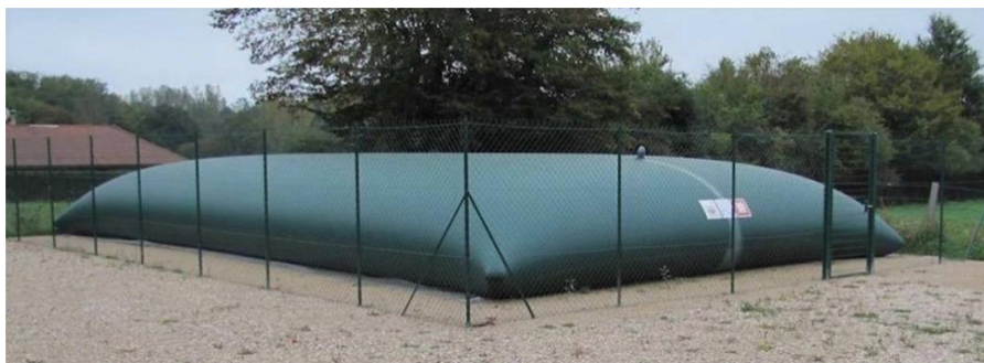
Figure 10 : Réserve d'eau incendie (Source : labaronne-citaf.fr)
