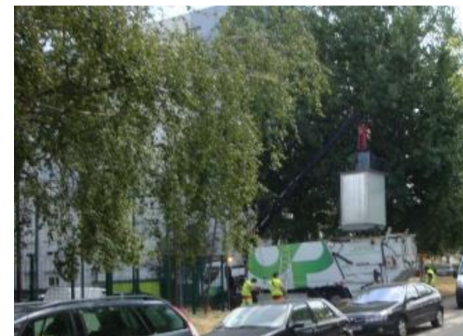
Collectes des déchets enterrés, rue Albert Doyen
